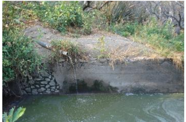
Imagen 31. Pila de almacenamiento de agua tratada
