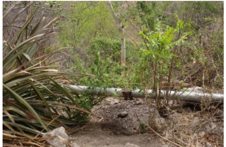
Imagen 18. Ducto de agua con fuga
