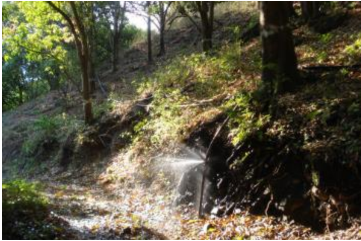
Imagen 21. Tubo con fuga.
