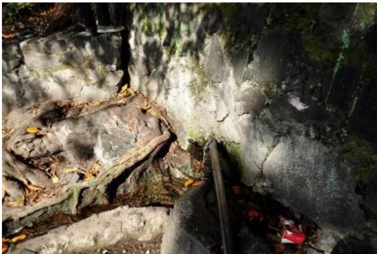
Imagen 9. Perforación en tubo del manantial para el llenado de cantaros y garrafones.
