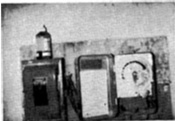
RELOJ CASETA AUTOMATIZADA
